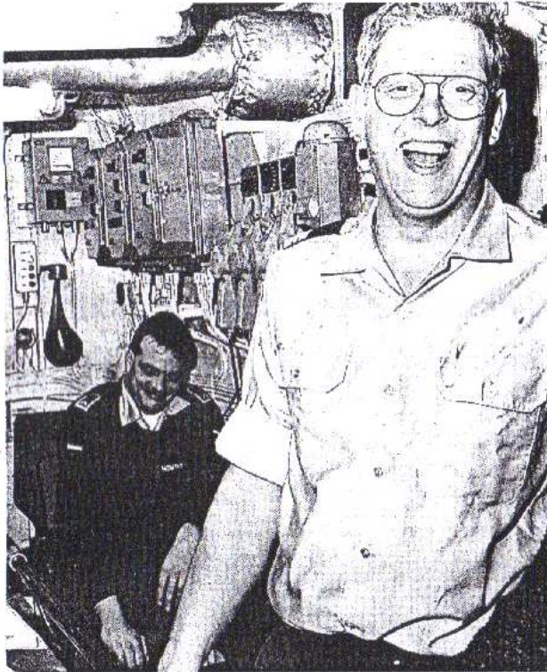
Von hier unten aus, tief unter Deck, steuert der Fahrmeister (hinten) die riesige Schiffsmaschine. Die Anweisungen erhält er von der Brücke über Maschinentelegraph.
